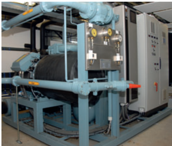
De warmtepomp staat opgesteld in gebouw Z, Koning Willem I College.
