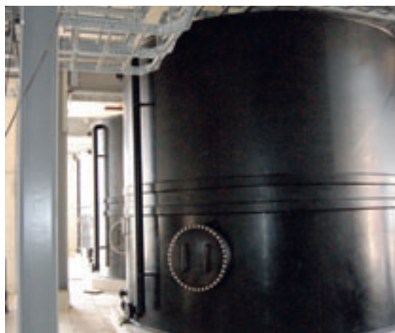
Watertanks in het turbinegebouw.
