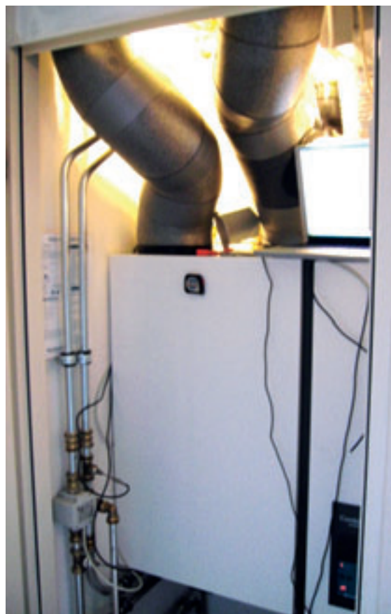
1. Hybride lucht-waterwarmtepomp ingebouwd in een kast. Het linkerdeel van het toestel omvat de warmtepomp, het rechterdeel de gasketel. Linksonder is de warmtemeter zichtbaar die wordt gebruikt voor monitoring.
