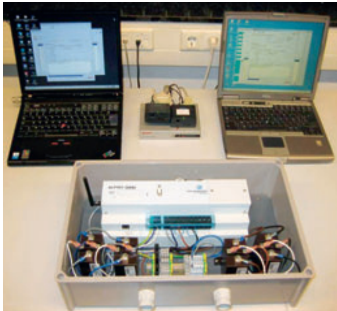
Netbeheerder Stedin meet in verschillende projecten het elektriciteitsverbruik van warmtepompen.
