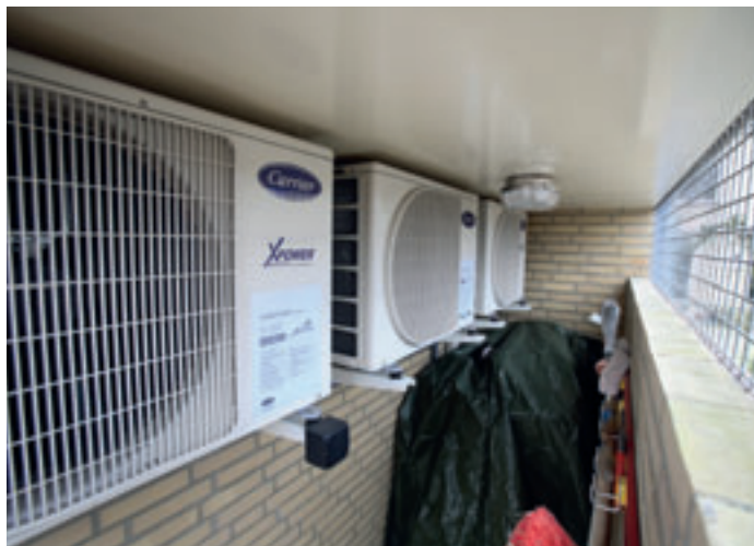
De opstelling van de Carrier-buitenunit, die bij John van de Wetering van Schilt Klimaattechniek in zijn schuur staat.
