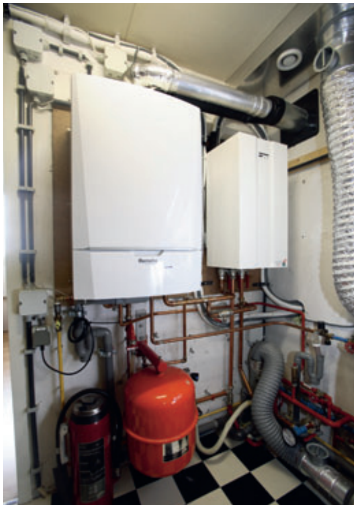
De opstelling van de Elga-binnenunit naast de hr-ketel van Remeha.
