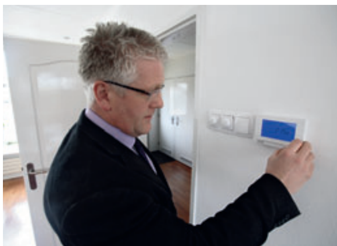
In de woning is de Elga aangesloten op een nieuwe Remeha Calenta met een iSense-thermostaat voor een regeling op ruimtetemperatuur.
